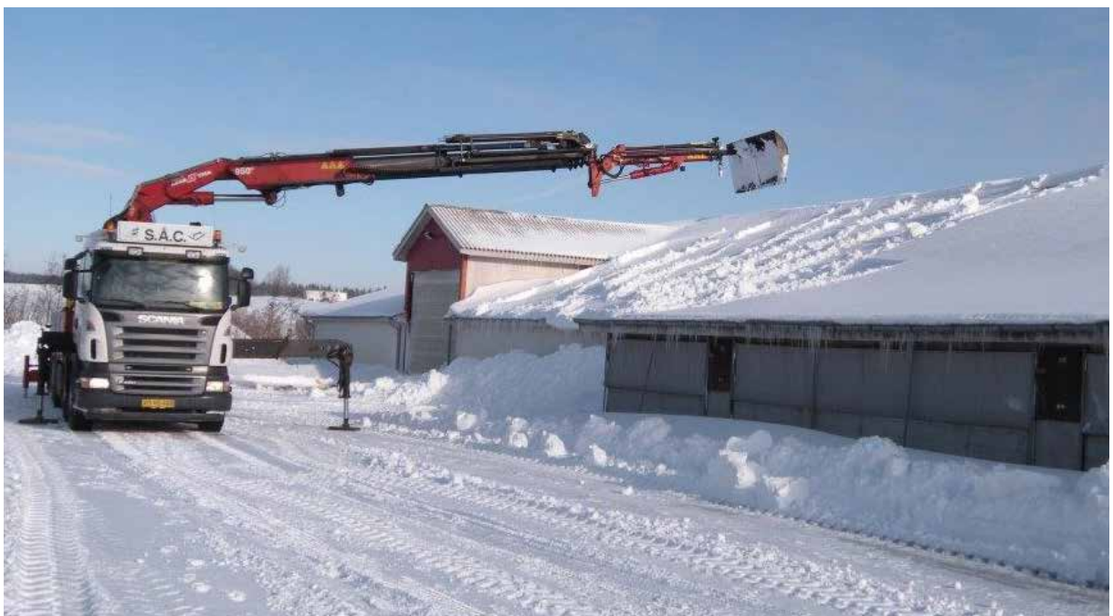
Sne fjernes fra taget af vognmandsfirma. På denne måde er der ingen risiko for, at personer falder ned.
