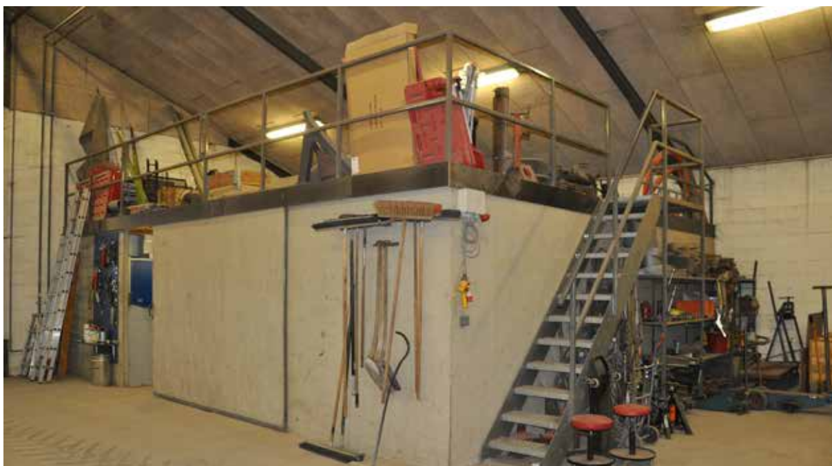
Rækværk over loft i værksted med fod-, knæ- og håndliste.
